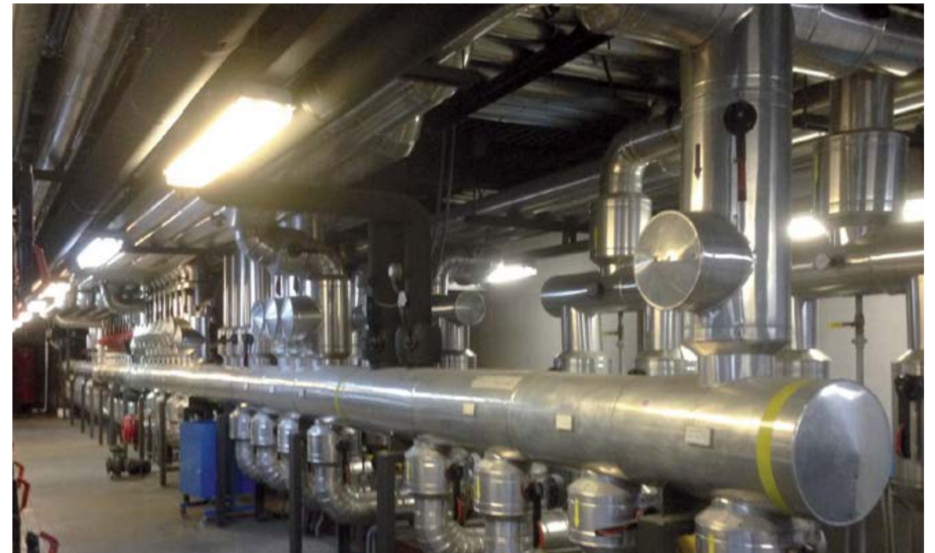
Adaptação da Central Frio/Calor no edifício Corporativo da Rádio Televisão Espanhola em Prado del Rey, Madrid (Espanha)
