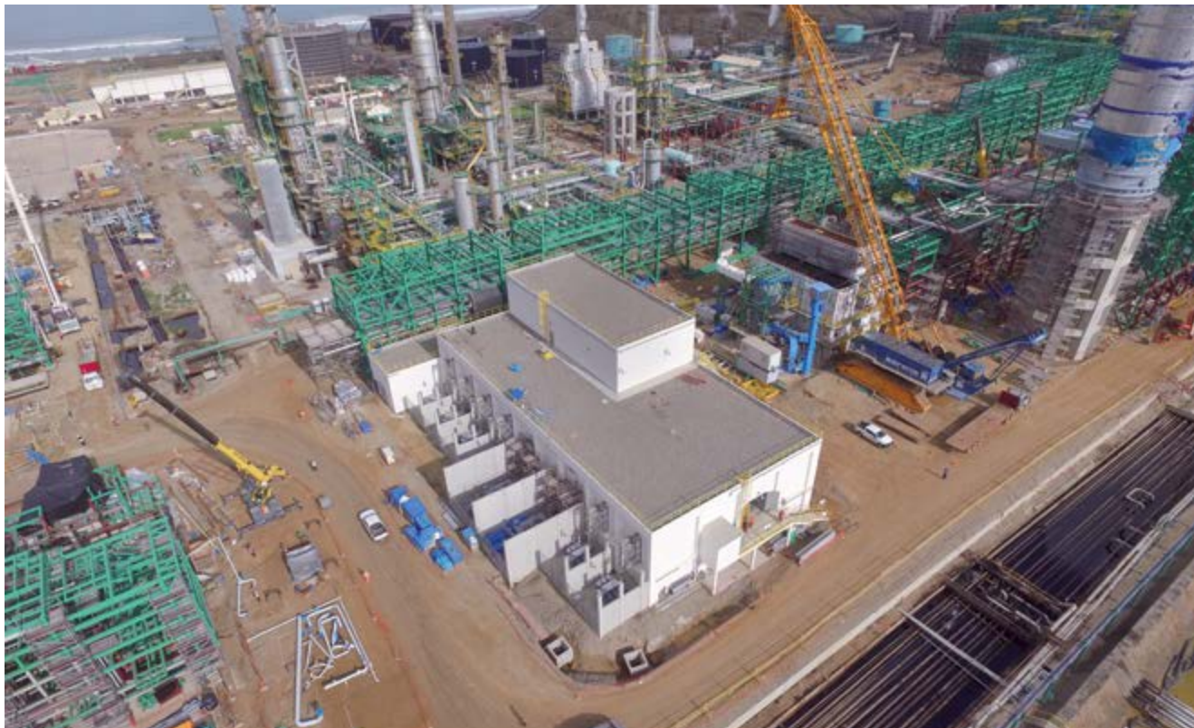
Edifícios de Controlo e Subestações Elétricas. Refinaria Talara - Piura (Peru)
