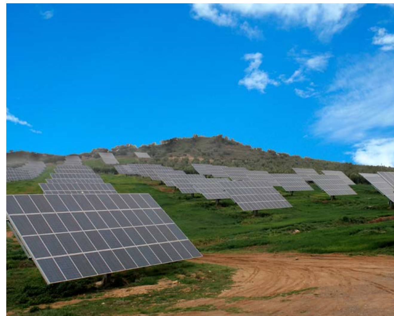
Central fotovoltaica em Alcaudete, Jaén (5,4 MW). Engenharia e projeto GSJ Solutions / Execução. SANJOSE Constructora
