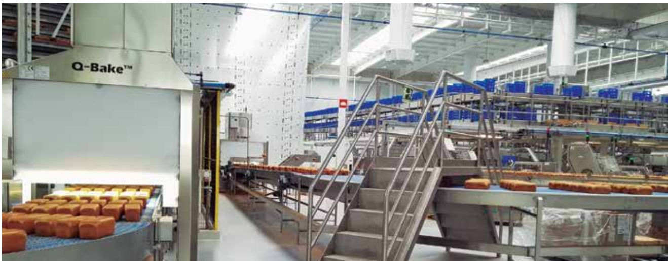
Instalações mecânicas e climatização da fábrica do Grupo Bimbo em Azuqueca de Henares, Guadalajara.
