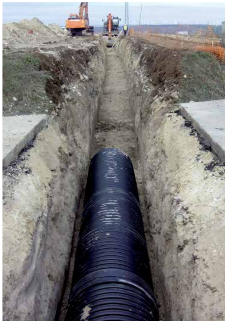
Anel de abastecimento e depósitos de água potável de Cortes, Burgos.
