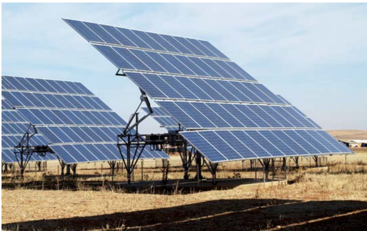
Parque Fotovoltaico de 3,33 MW em Toro, Zamora
