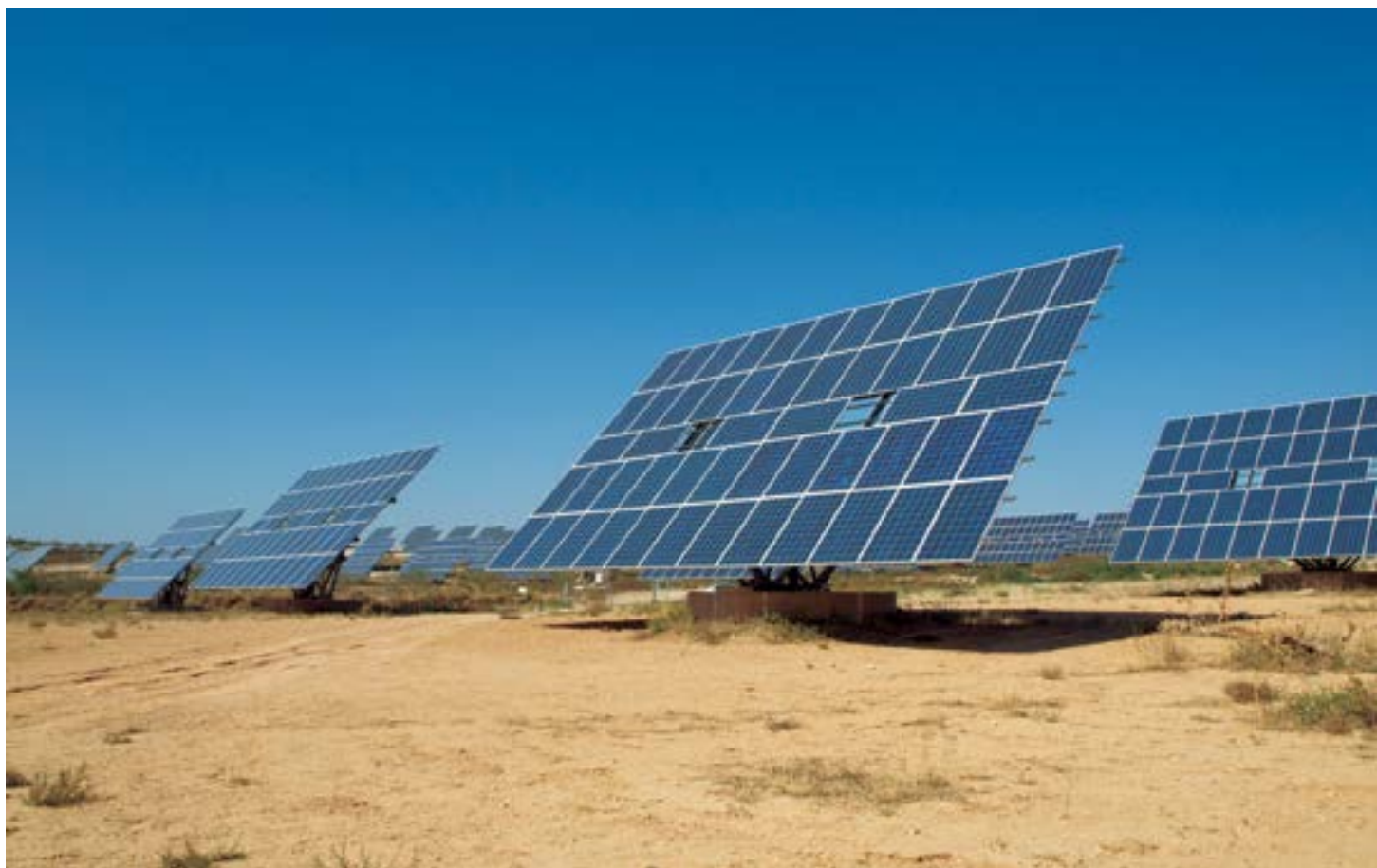
Parque Fotovoltaico de 8,89 MW em Valtierra, Navarra
