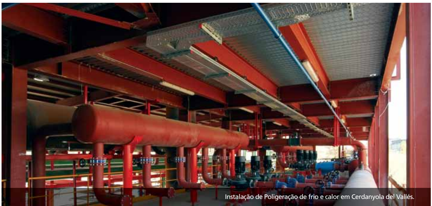
Instalação de Poligeração de frio e calor em Cerdanyola del Vallés.
