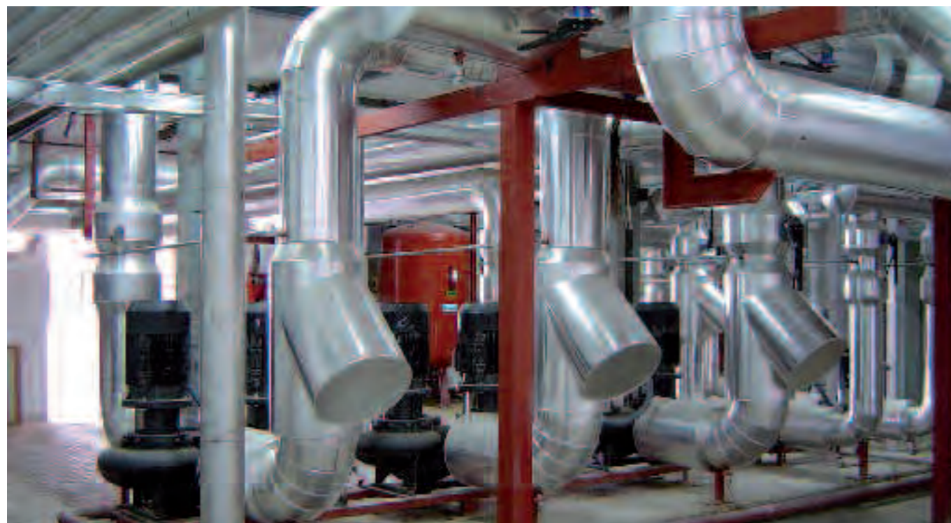
Instalações no Hospital de Jaén.
