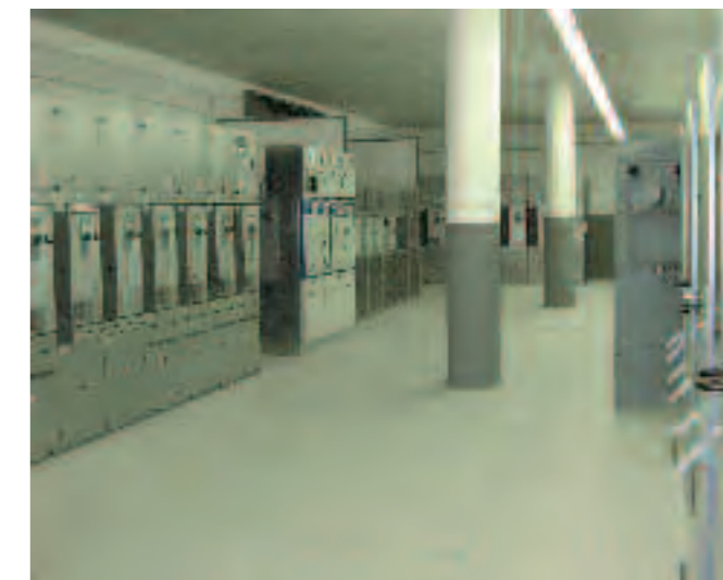
Subcentral eléctrica, Anoia e El Bages.
