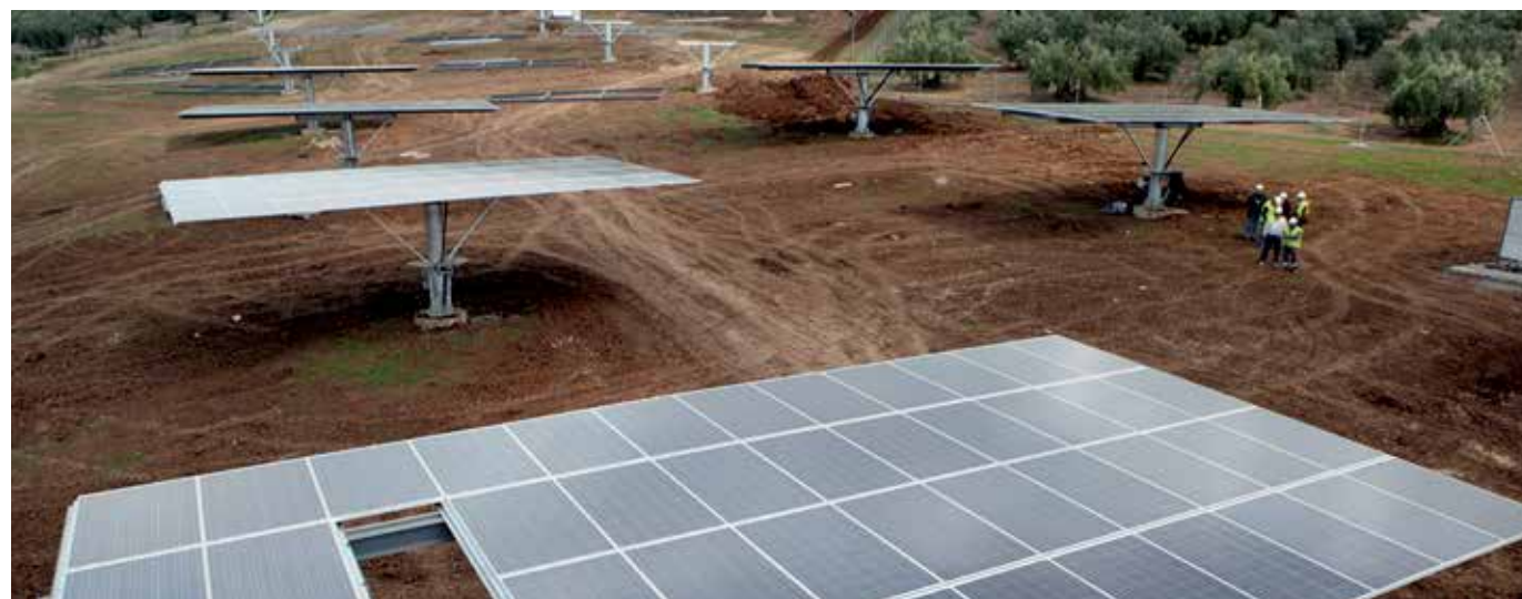
Parc solaire photovoltaïque de 5,4 MW à Alcaudete, Jaén (Espagne)
