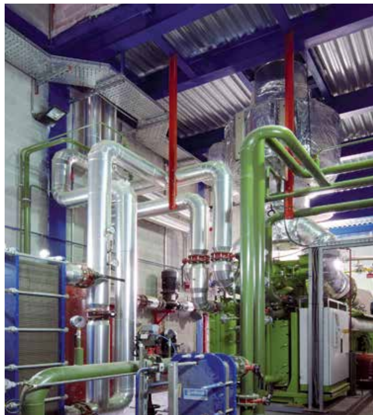
Salle de moteurs de cogénération
