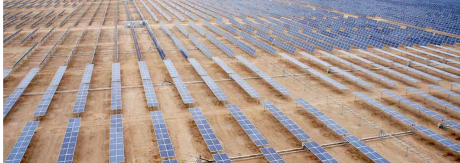
Parc photovoltaïque dans l'Alto de la Alianza, Tacna (Pérou)
