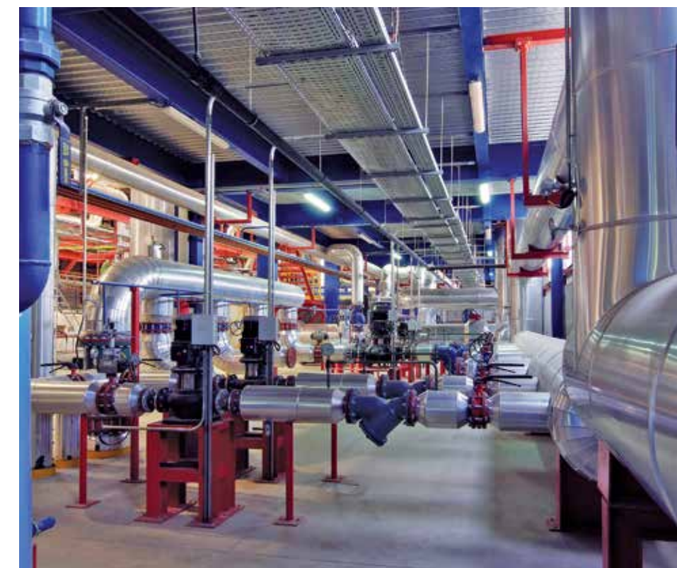
Système de pompage DHC
