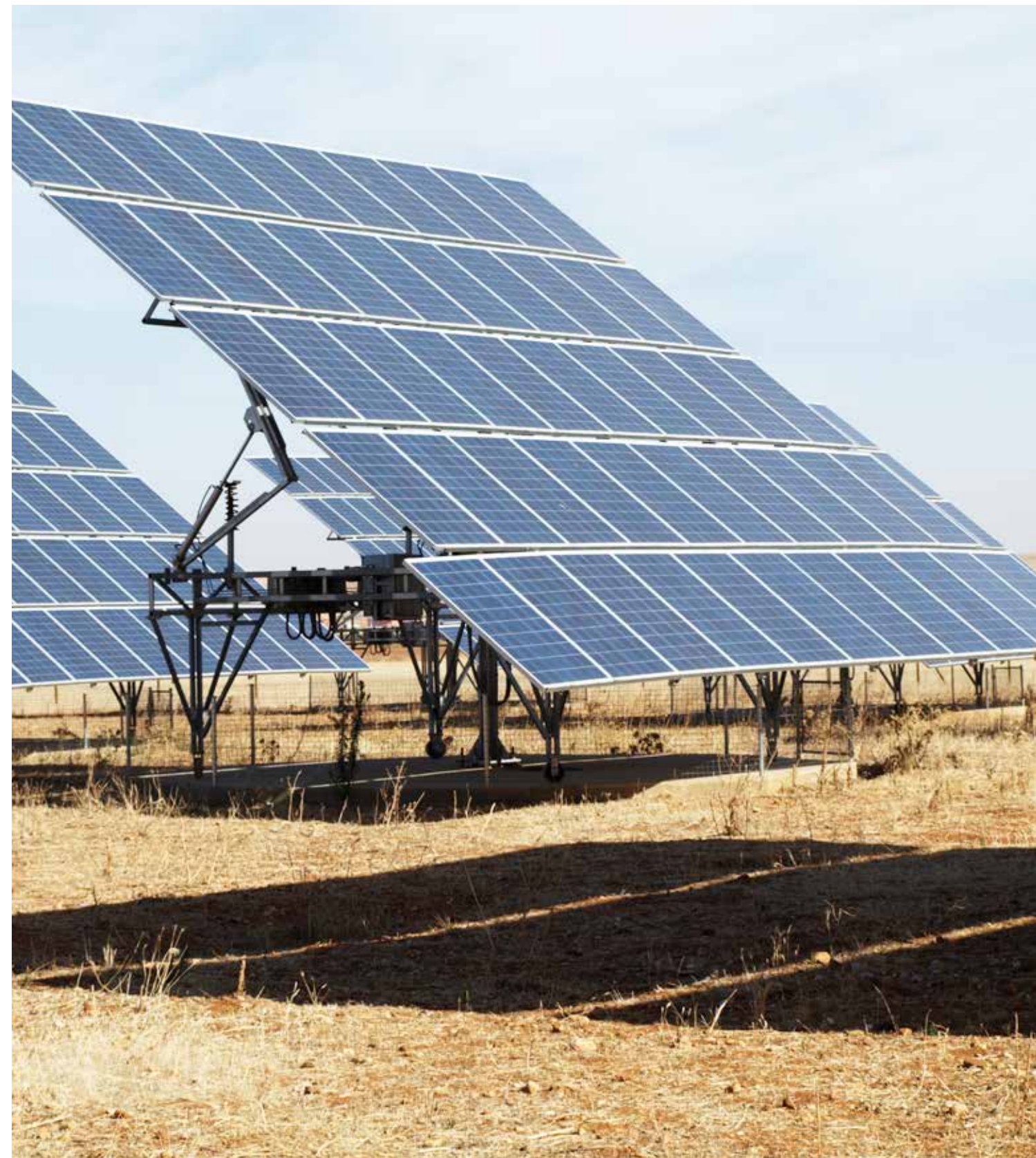
Parc solaire photovoltaïque de 3,33 MW à Toro, Zamora (Espagne)
