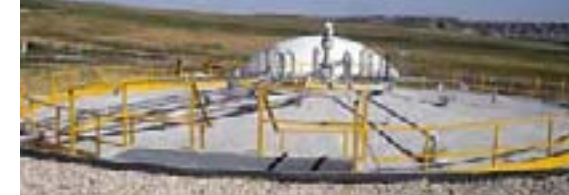
Couverture de digesteur Station d'épuration Arroyo de la Vega, Madrid
