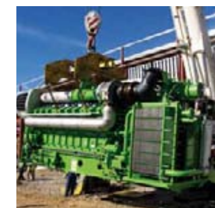
Usine de Polygénération (froid et chaleur) à Cerdanyola del Vallés, Barcelone
