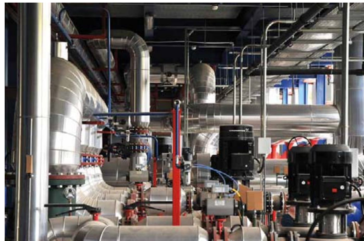
Usine de Polygénération (froid et chaleur) à Cerdanyola del Vallès, Barcelone
