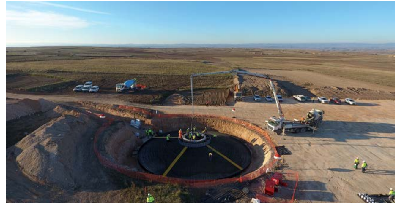
Parque eólico de 50,4 MW en Muniesa, Teruel
