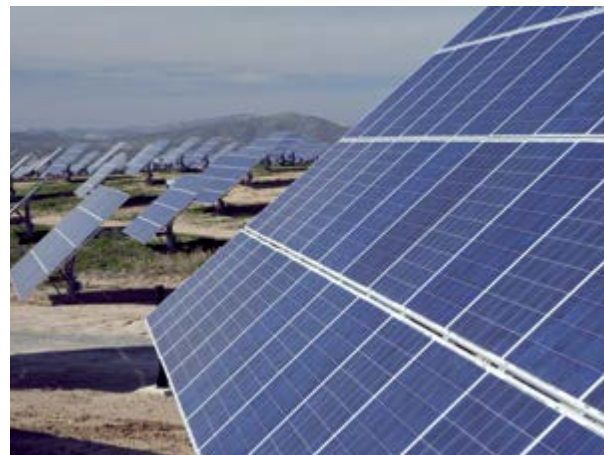
Planta fotovoltaica en Alcaudete, Jaén / 5,4 MW
