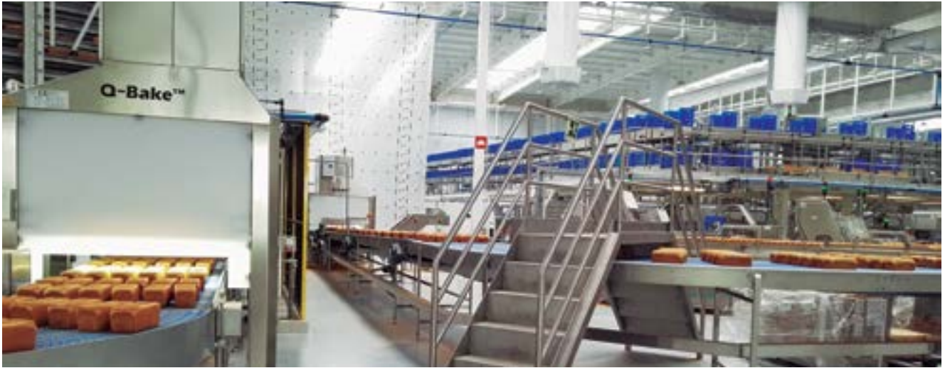
Instalaciones mecánicas y climatización de la fábrica del Grupo Bimbo en Azuqueca de Henares, Guadalajara
