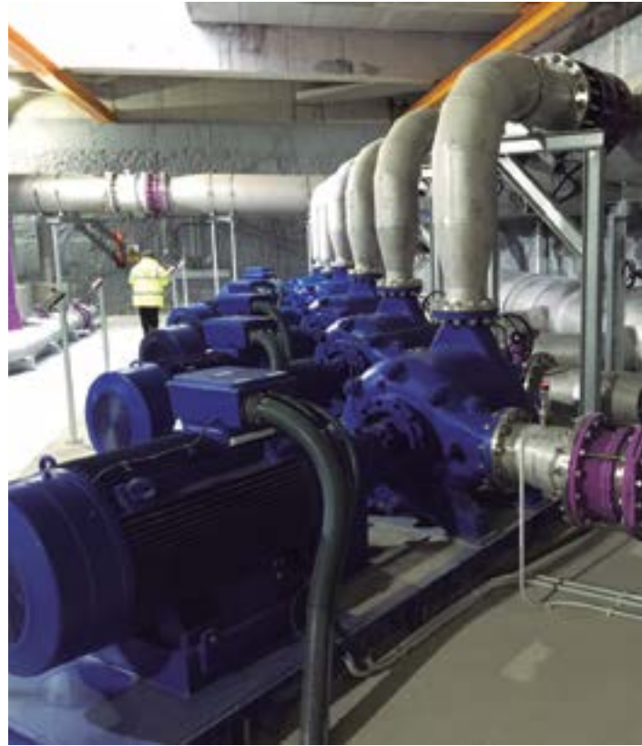
■ Suministro de agua de Arroyo Culebro, Madrid
