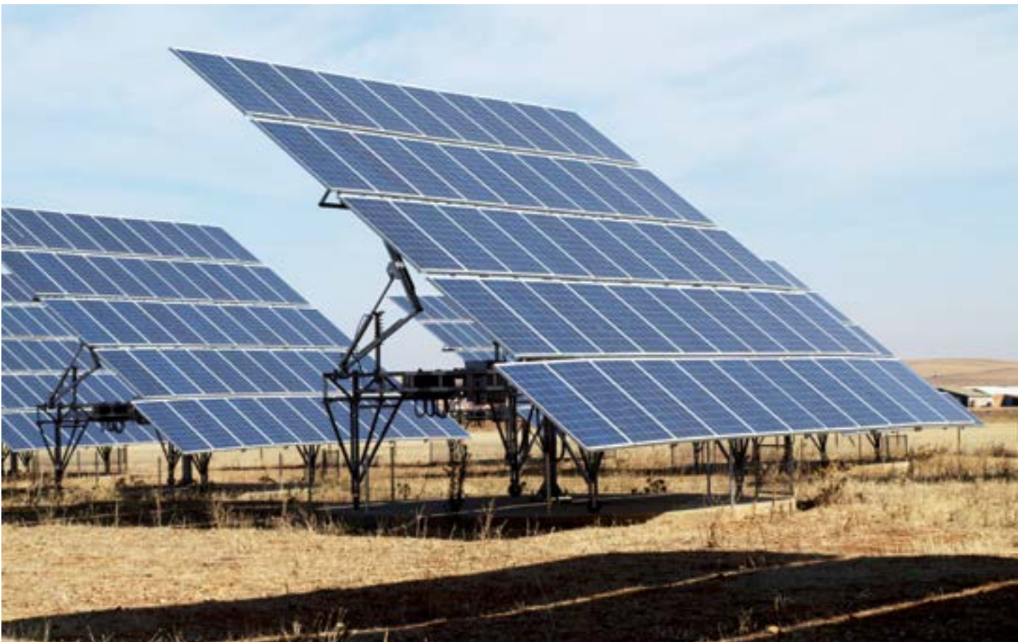
■ Parque solar fotovoltaico de 3,33 MW en Toro, Zamora
