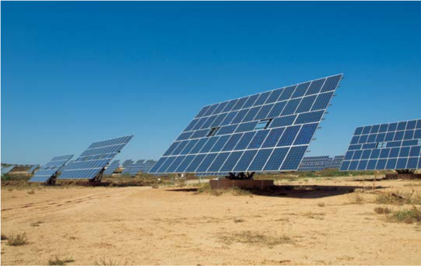
■ Parque solar fotovoltaico de 8,89 MW en Valtierra, Navarra
