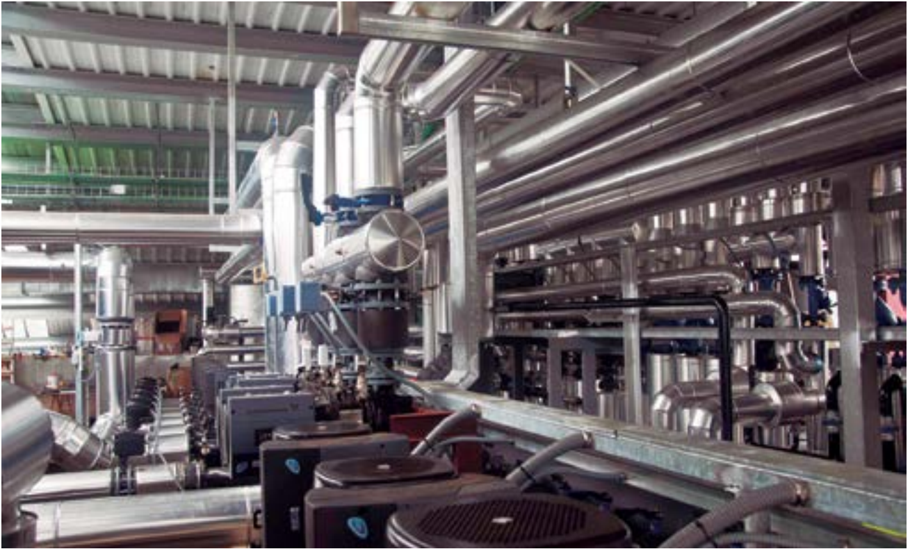
■ Instalaciones eléctricas del Edificio Terminal del Aeropuerto de Vigo
