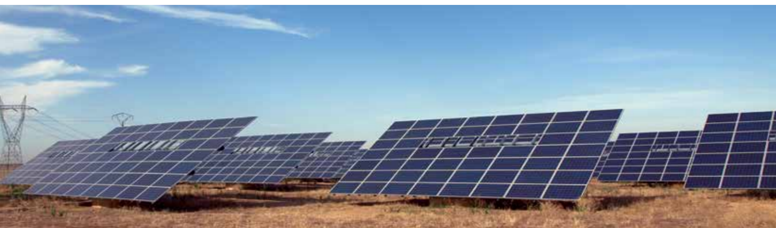
Parque solar fotovoltaico en Ciguñuela, Valladolid
