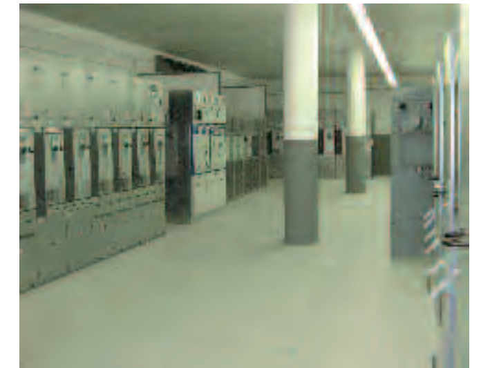
Subcentral eléctrica, Anoia y el Bages.
