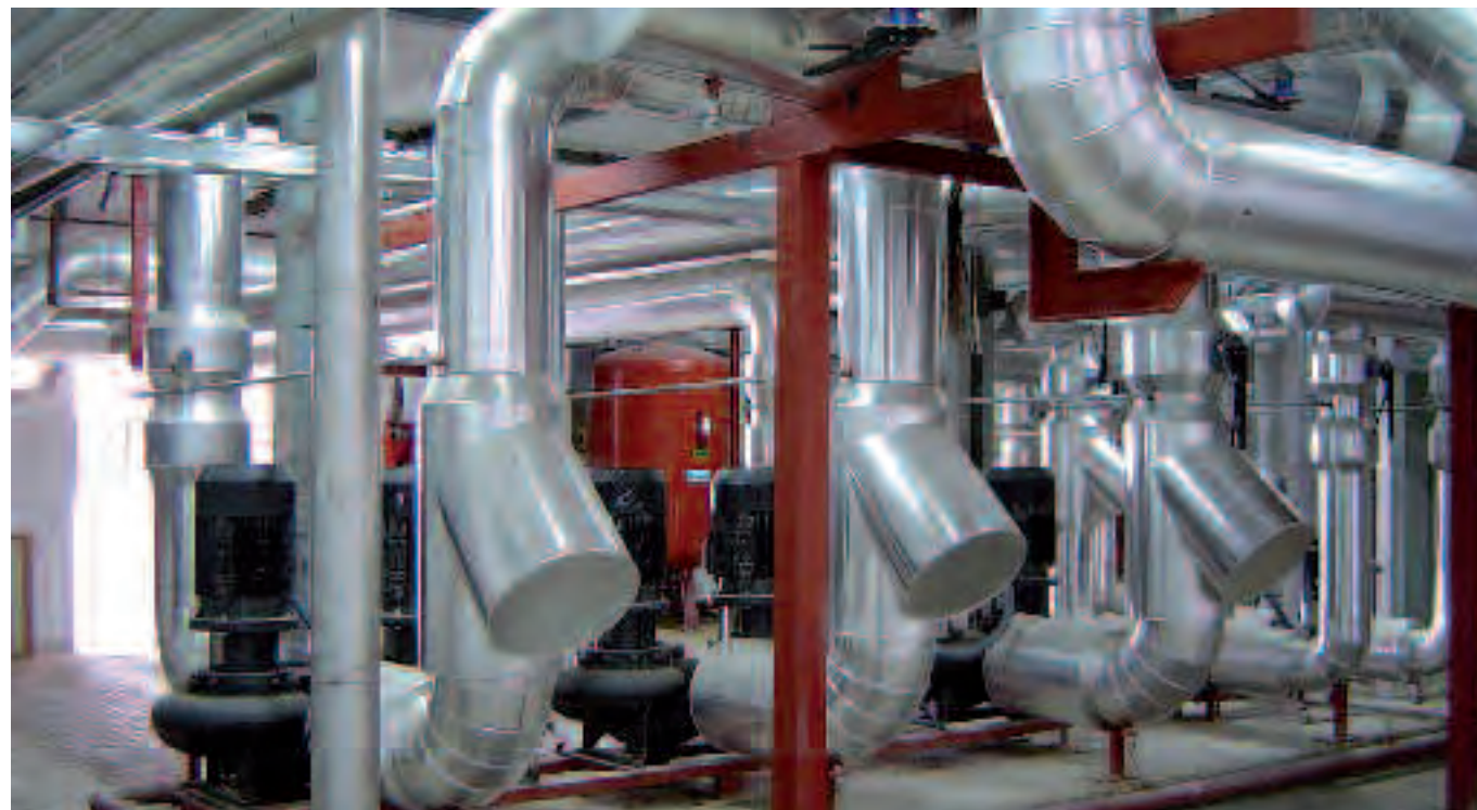
Instalaciones en el Hospital de Jaén.
