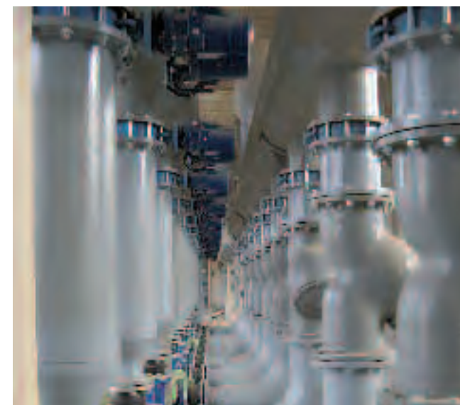
Central Energética del Aeropuerto de Barcelona.
