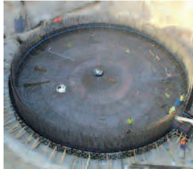
Arroyo de la Vega WWTP, Madrid.
