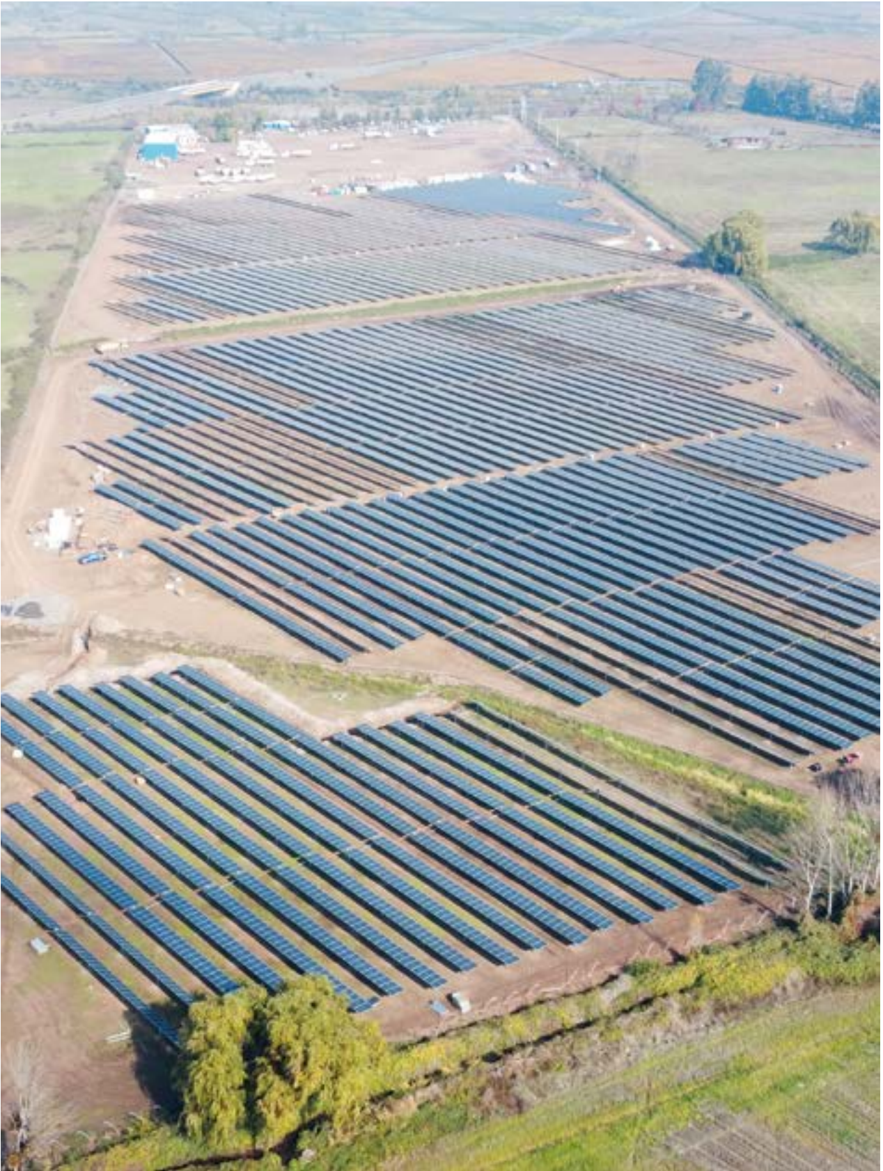
Centrale photovoltaïque de Milan, Région du Maule (Chili). 7,36 MW
