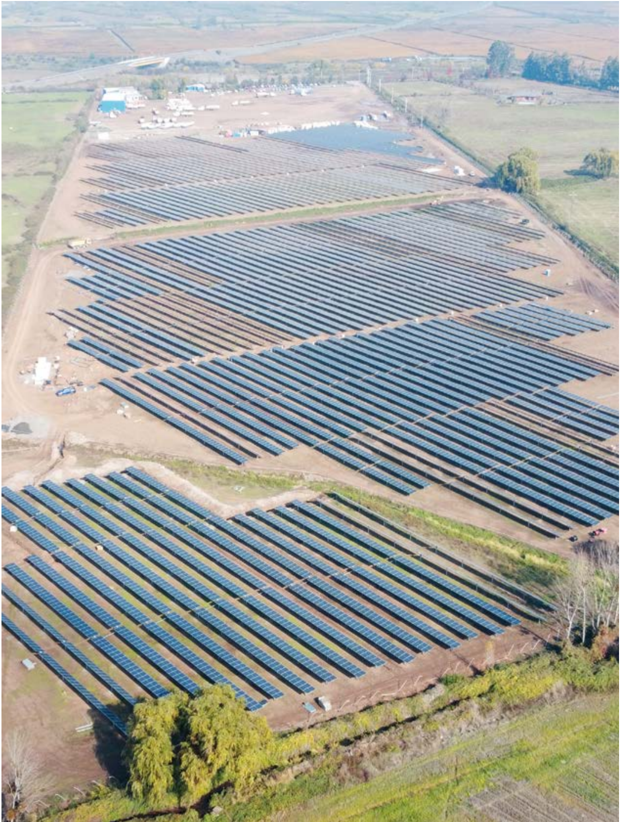
Parque fotovoltaica de Milán, Región de Maule (Chile).7,36 MW
