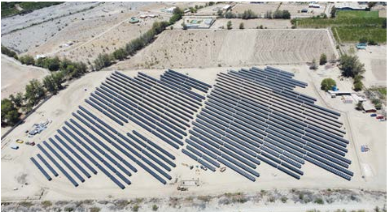
Planta fotovoltaica Olivier, Región de Coquimbo (Chile). 3 MW
