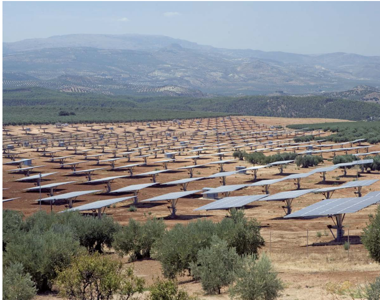
Planta fotovoltaica en Alcaudete, Jaén / 5,4 MW.
