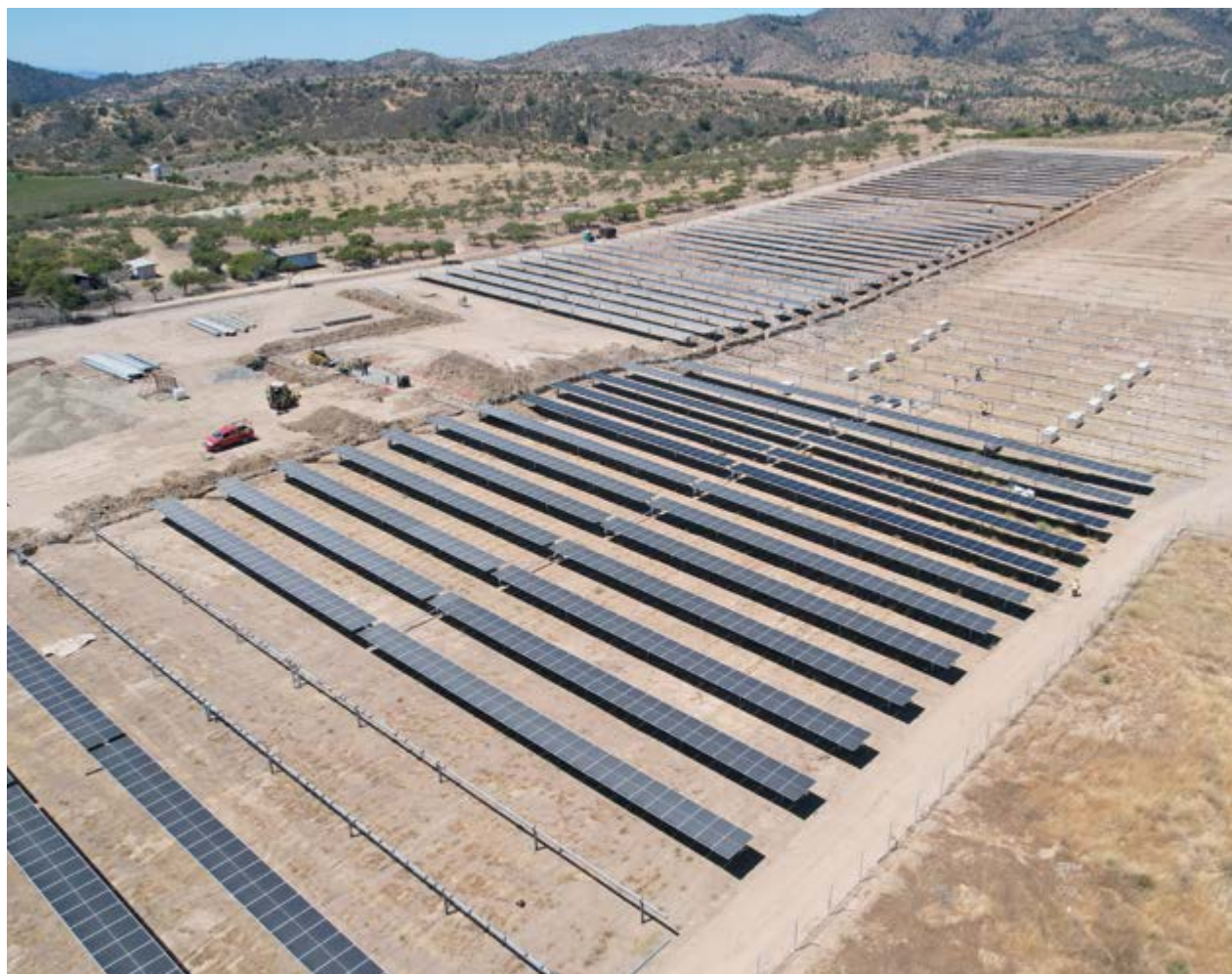
Planta fotovoltaica de Cantera de 3 MW (Chile)
