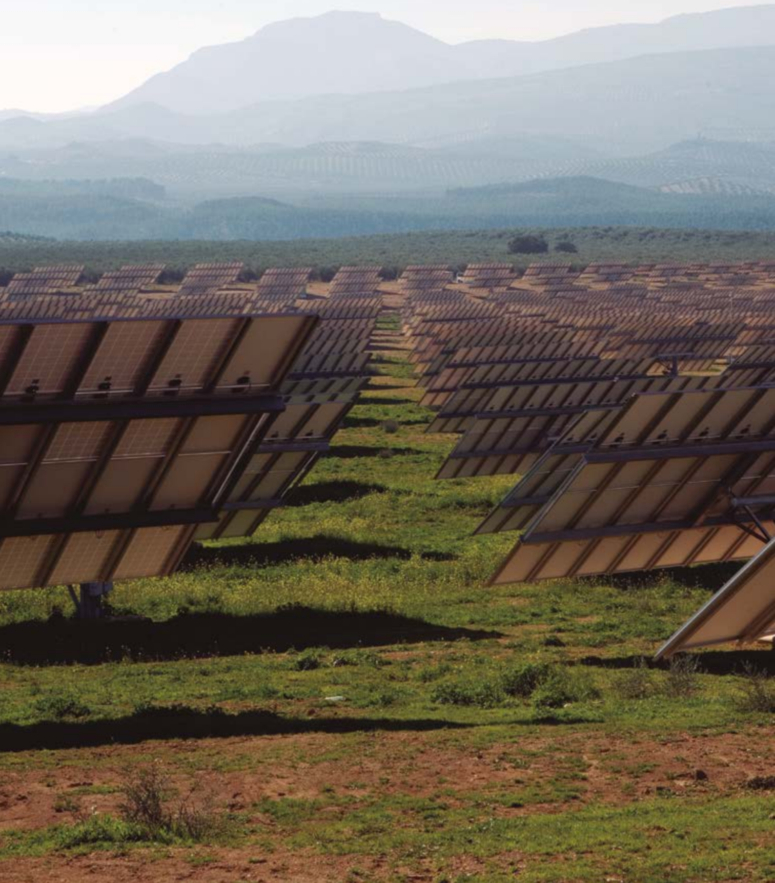
Planta fotovoltaica de 5,4 MW en Alcaudete, Jaén (España)
