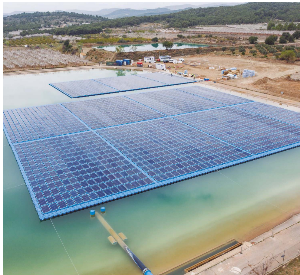
Bombeo solar flotante sobre balsa y dos bombas subterráneas para el autoconsumo de la Comunidad de Regantes de Liria, Valencia (España)
