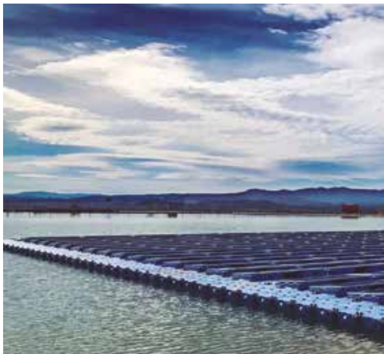
Bombagem solar flutuante sobre balsa e duas bombas subterrâneas para consumo próprio da Comunidade de Regantes de Lliria, Valencia (Espanha)
