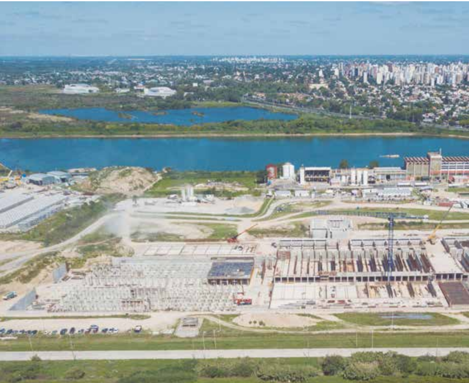
Estação de Tratamento de Águas General Belgrano, Buenos Aires (Argentina)
