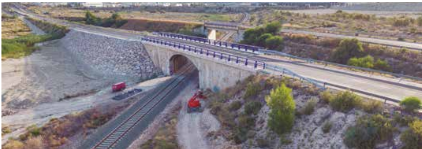
Reparação da ponte sobre os caminhos-de-ferro na N-301 em Lorquí, Múrcia (Espanha)
